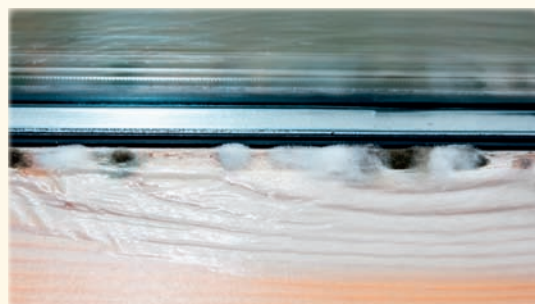
Schimmel schadet der Gesundheit.
